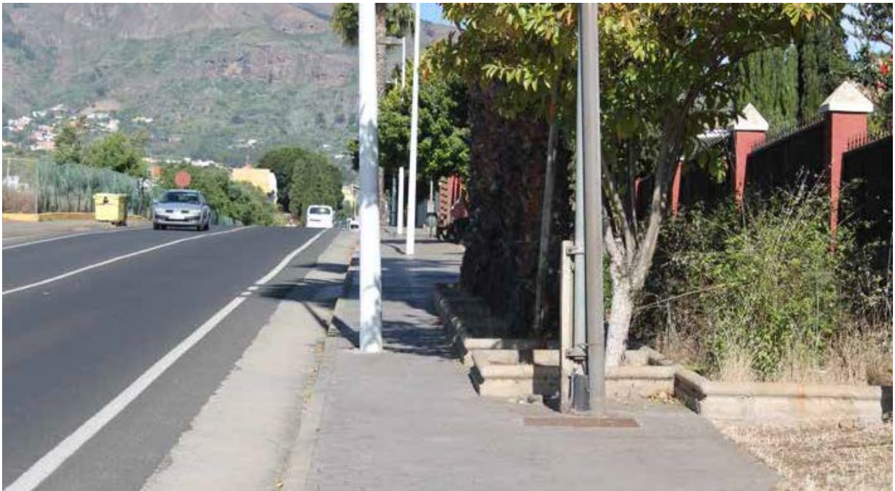
Algunas aceras del Municipio presentan barreras arquitectónicas debido a su diseño inadecuado. Travesía urbana GC-41.
