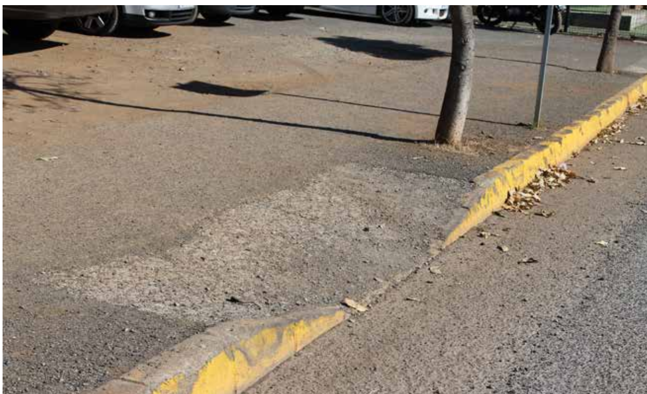
En el municipio de Valsequillo de Gran Canaria se detectan numerosos puntos de conflicto que dificultan la movilidad peatonal, especialmente la de las personas con movilidad reducida.
