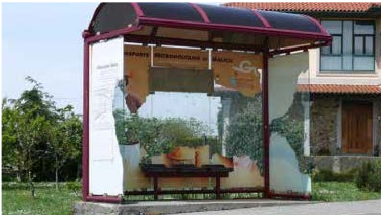
Marquesina no apta para personas con movilidad reducida o discapacitados.
